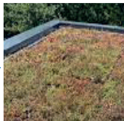
Toit terrasse végétalisé Albédo : 0,35 IRS : pas de donnée
