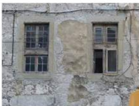
Ci-contre exemple d'alimentations directes par tresse en façade
