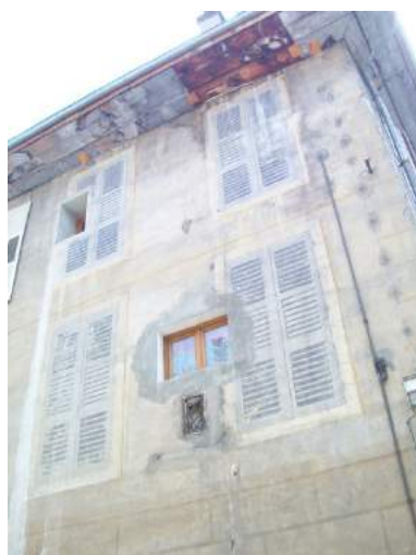
Façade en trompe l'œil (altérée)
