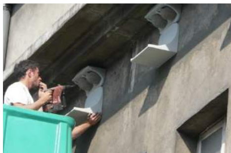
Nichoirs de substitution proposés aux hirondelles, avec planchettes anti-fientes afin d'éviter les nuisances. Caserne de Bonne, Grenoble
