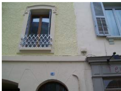
Enduit prêt à l'emploi inadapté !
